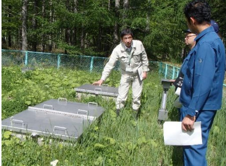
南平配水池で、点検用の設備の説明を受ける。中に流量計があり、水量を計っている様子が見えた。
