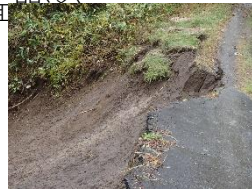
路肩の崩れた道路
