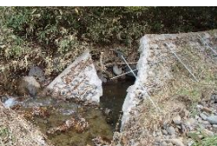
川の方に倒れた擁壁 (中尾地区)
