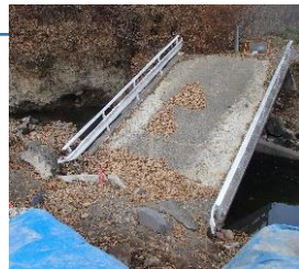
落下した梨木橋
