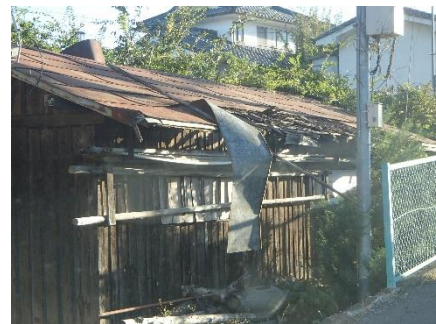
強風でトタンが捲(めく)れた屋根(町区)
