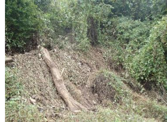
正明寺から古町へ抜ける道、右斜面が崩落。↑せつかく遊休農地を復田したのに、土砂で覆われてしまった田。↓
