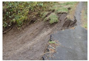
台風により路肩の崩れた道路
