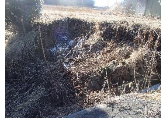
崩れた水田の法面(塩沢)
