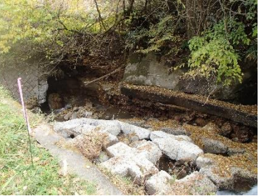
破壊された用水路
