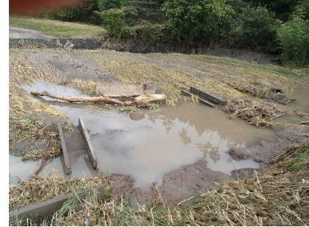
破壊された用水路と泥をかぶった取り入れ前の田
